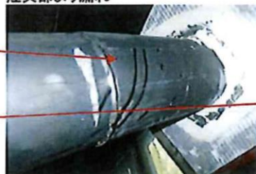
煙突部より漏れ
