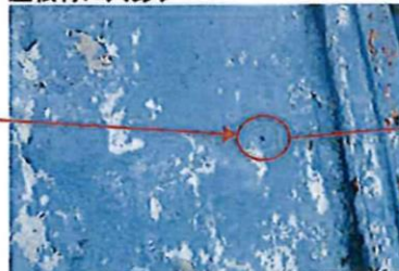
屋根材に穴あり
