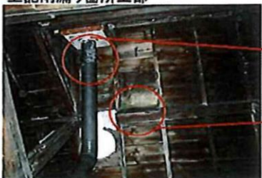
上記雨漏り箇所上部
