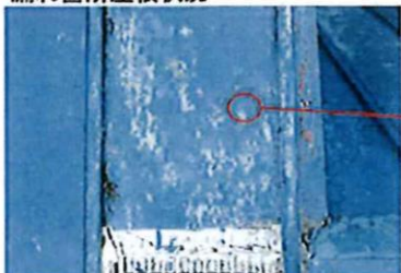
漏れ箇所屋根状況
