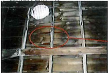
上記雨漏り箇所上部
