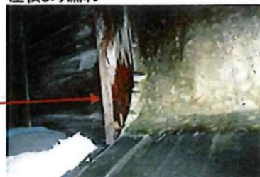
屋根より漏れ
