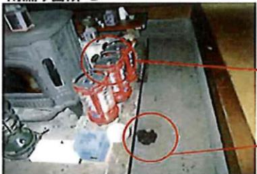
雨漏り箇所-B
